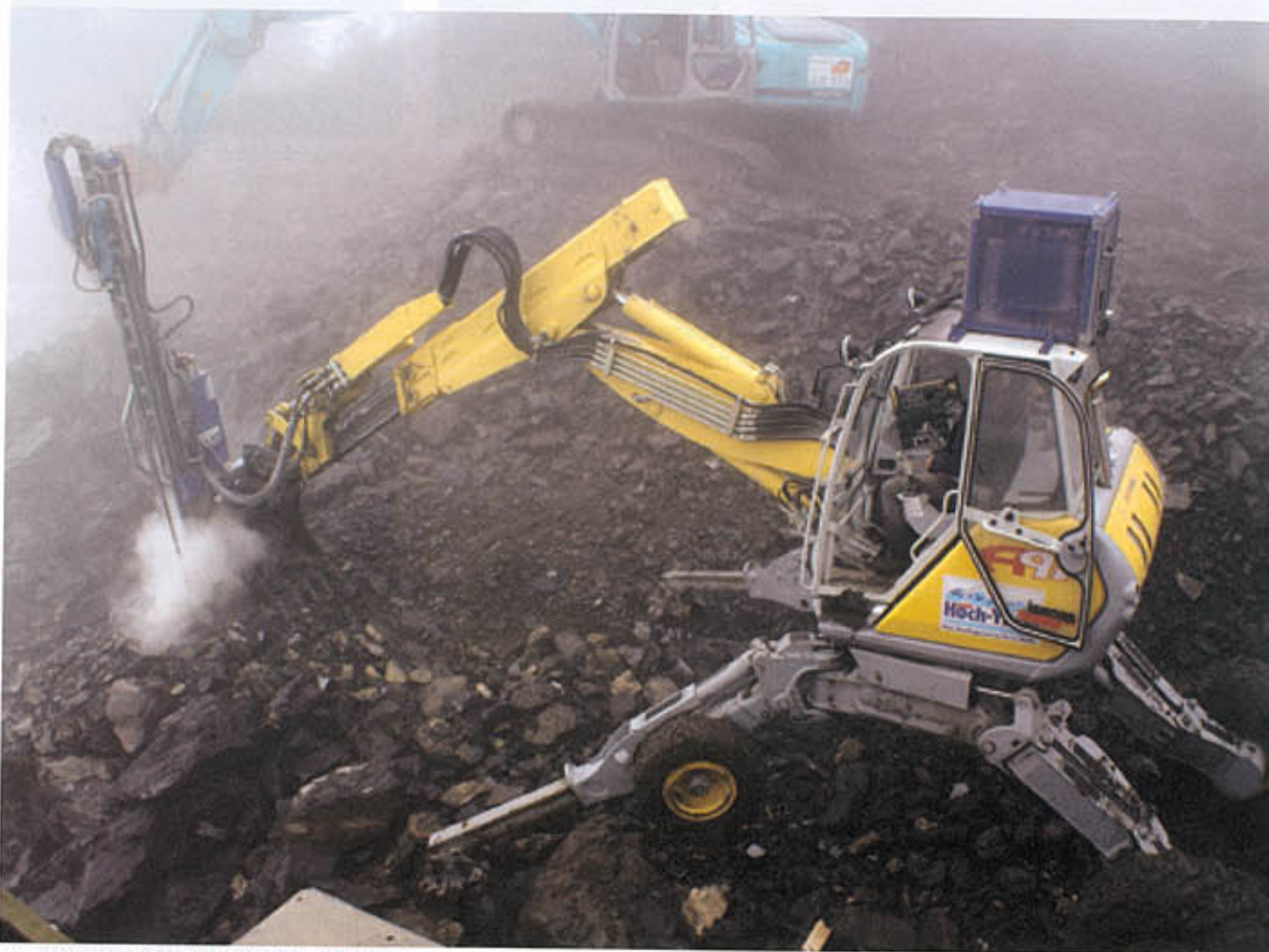
Menzi Muck „A91 mit Bohrlafette“ im Bohreinsatz in Aktion. Kompressor auf dem Dach. Der Bagger (oben) räumt den Schutt der letzten Sprengung weg; die beiden Maschinen arbeiten effizient parallel.
