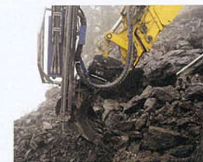
De petits travaux avec la pelle rétro peuvent être effectués sans démonter l'affût de forage.
